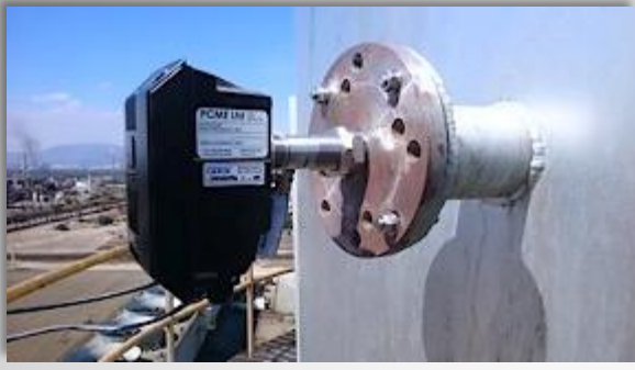
Monitor Electrodinámico en Planta de Energía
