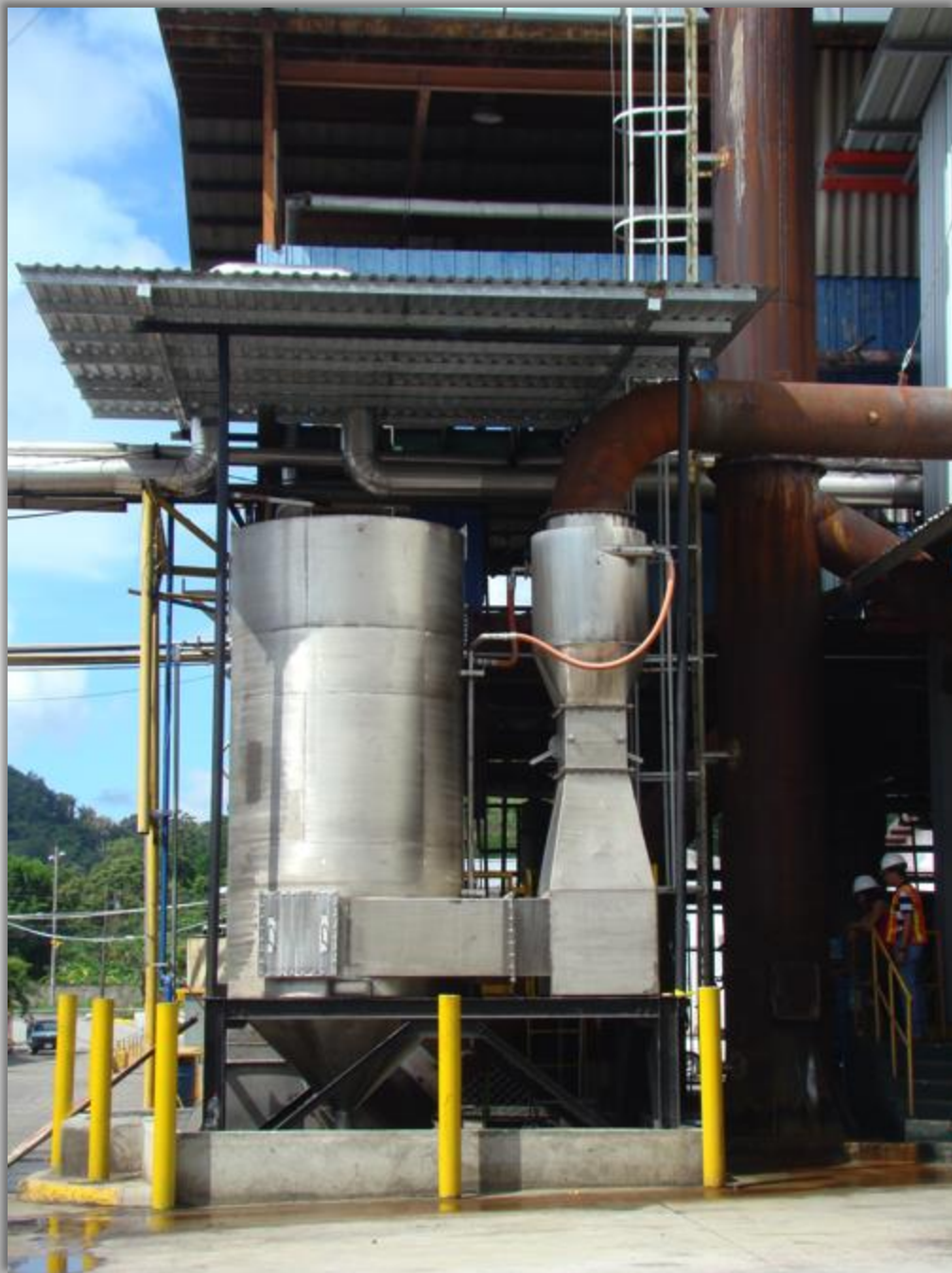
Lavador Venturi en Caldera de Biomasa 20,000 cfm
