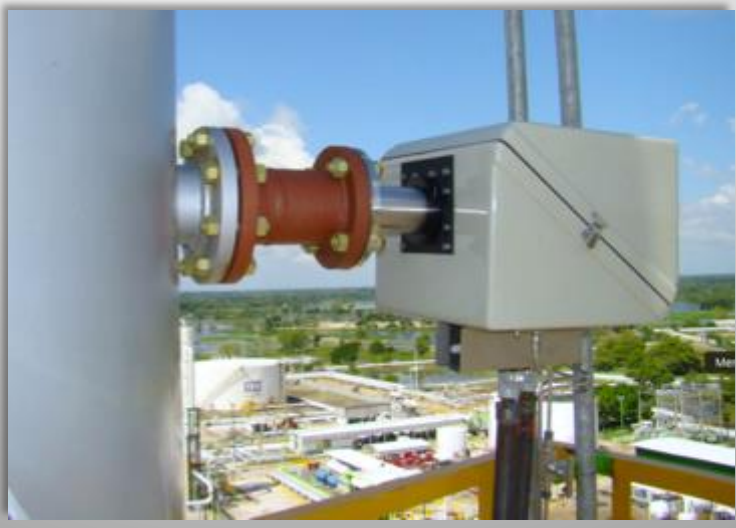
Monitor Multigases Tipo Infrarrojo No Dispersivo en Planta Petroquímica.
