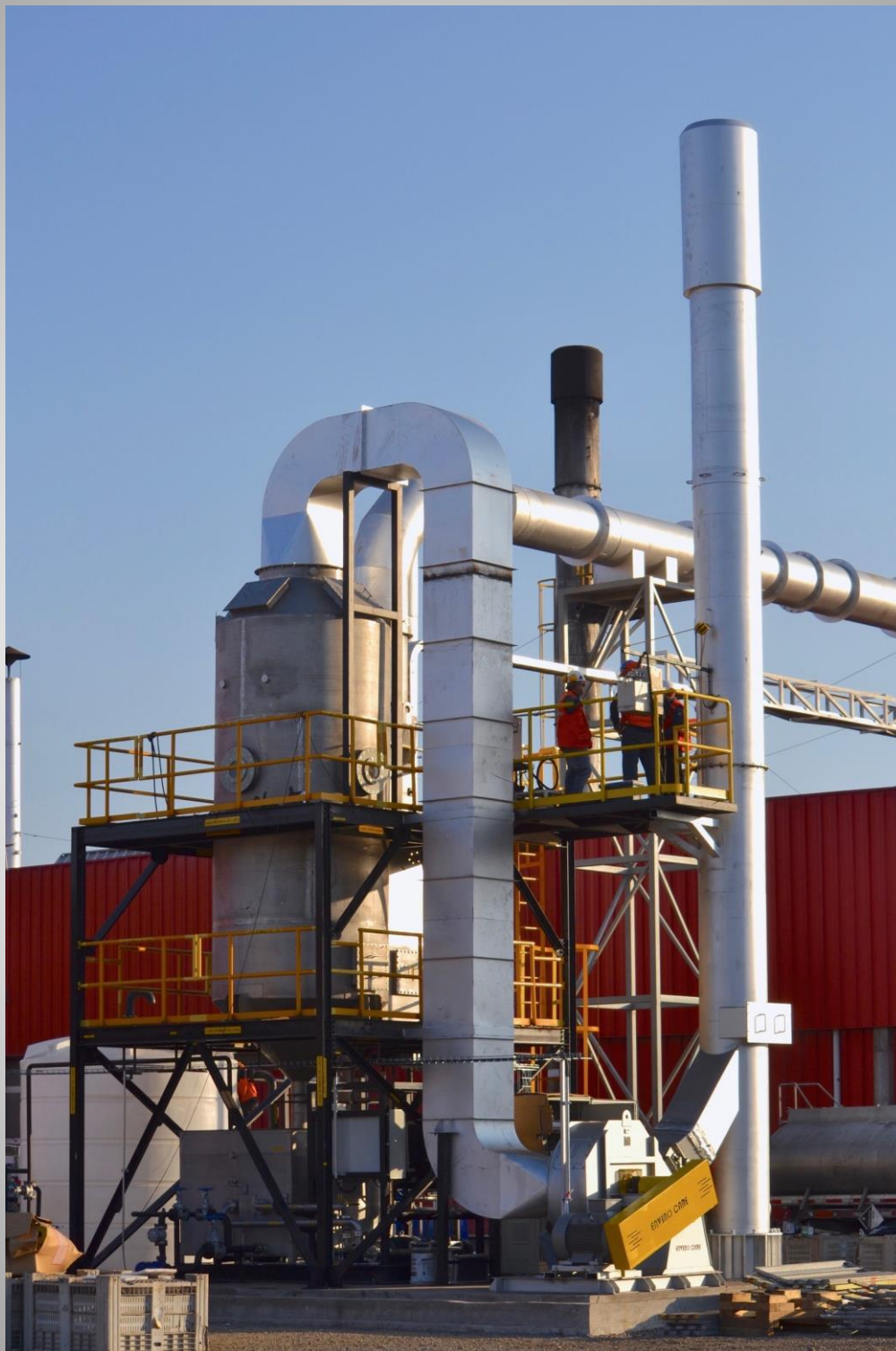
Lavador de Gases Aralco® en caldera de Carbón Bituminoso. Captura SO_2 y Materia Particulada. Opera 36,000 acfm.
