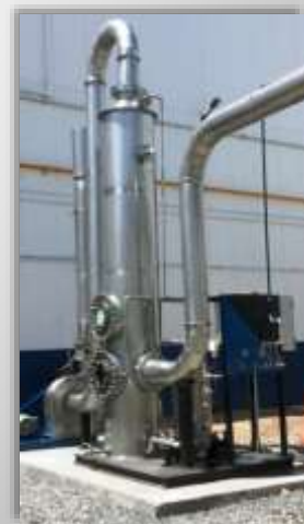
Lavador de Gases Torre Empacada.
