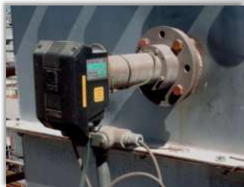
Monitor de Dispersión Luminosa en planta cementera – Monterrey NL
