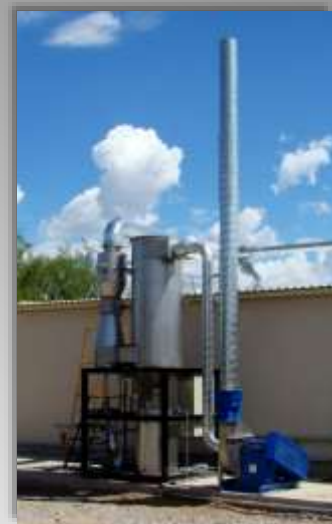
Lavador de Gases Venturi Variable.
