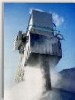
Descarga de banda en apilamiento con aspersores de Niebla Seca formando un anillo.
