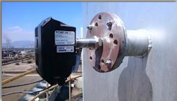
Monitor Electrodinámico en Planta de Energía
