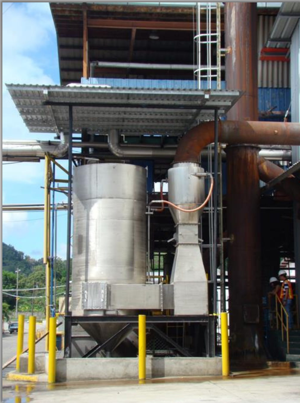
Lavador Venturi en Caldera de Biomasa 20,000 cfm
