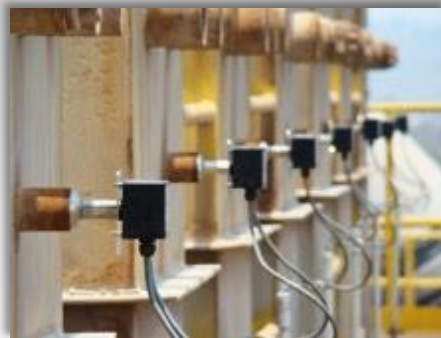
Sensores de Bolsas Rotas en Planta de Cemento
