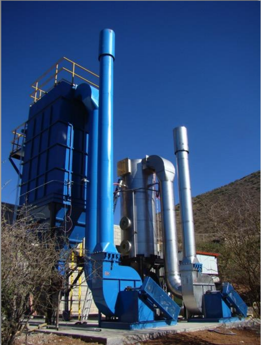
Colectores de Polvos en Laboratorio Químico 15,000 cfm
